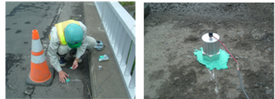
写真-2 センサー設置状況
